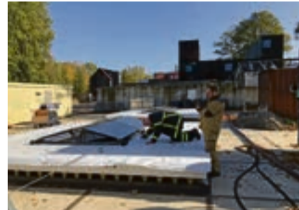
▲ Grootschalige brandtest met glas-glas zonnepanelen op EPS-dak: waarneming van de beperkte schade aan het dak.
