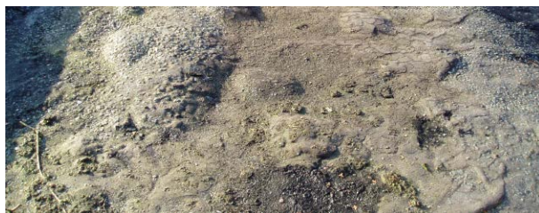
Stilstaand water kan de dakbedekking ernstig beschadigen
