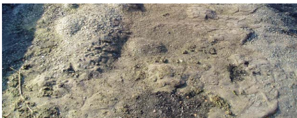
Stilstaand water kan de dakbedekking ernstig beschadigen
